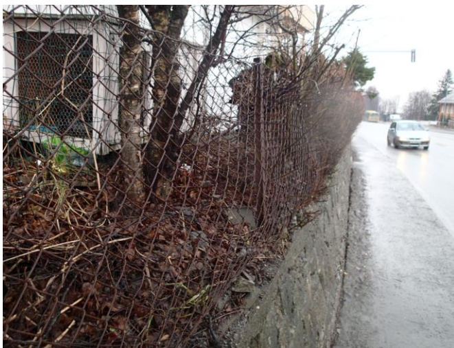
Figur 2: Støttemur mot trangt fortau.
