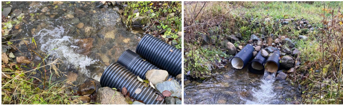
Figur 7.71. Plastrør i Flakkbekken kan hindre sjøørreten til å utnytte gyteområder ovenfor.
