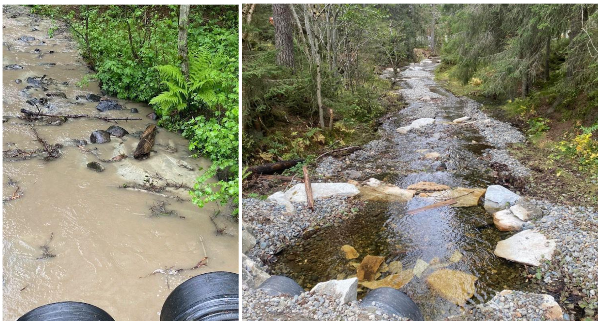
Figur 7.74. Til venstre: Betydelig slam- og partikkelbelastning i forbindelse med gravearbeider i og ved bekkeløpet i juni 2022. Til høyre: Bekkeløp etter tiltak med fjerning av slam og utlegging av nytt bekkesubstrat i august 2022.
