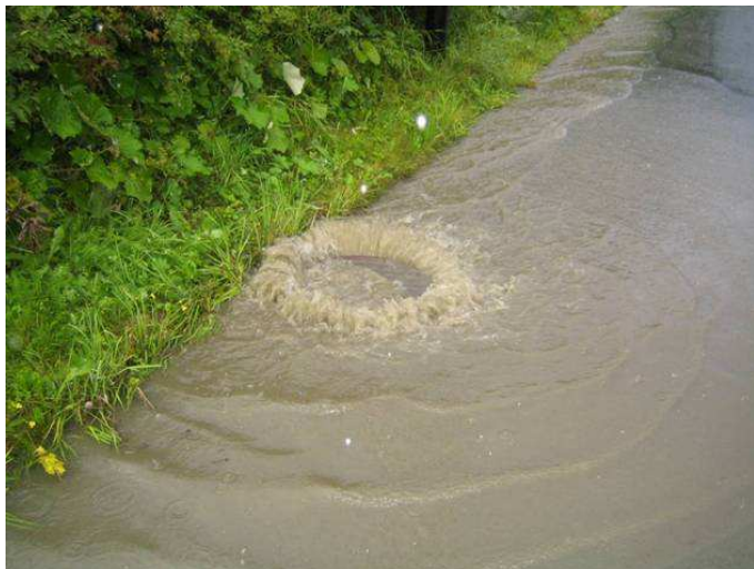
Figur 5.1: Oppstuvning over bakkenivå for regnhendelsen 13.08.2007 i avløpskum (kum nr. 5715) på avskjærende ledning i Bjørndalen. Foto: V. Knotten.
