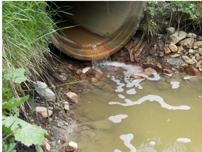
Figur 5.3: Utløp fra overvannsledning på Heggstadmoen. Foto: Trondheim kommune
