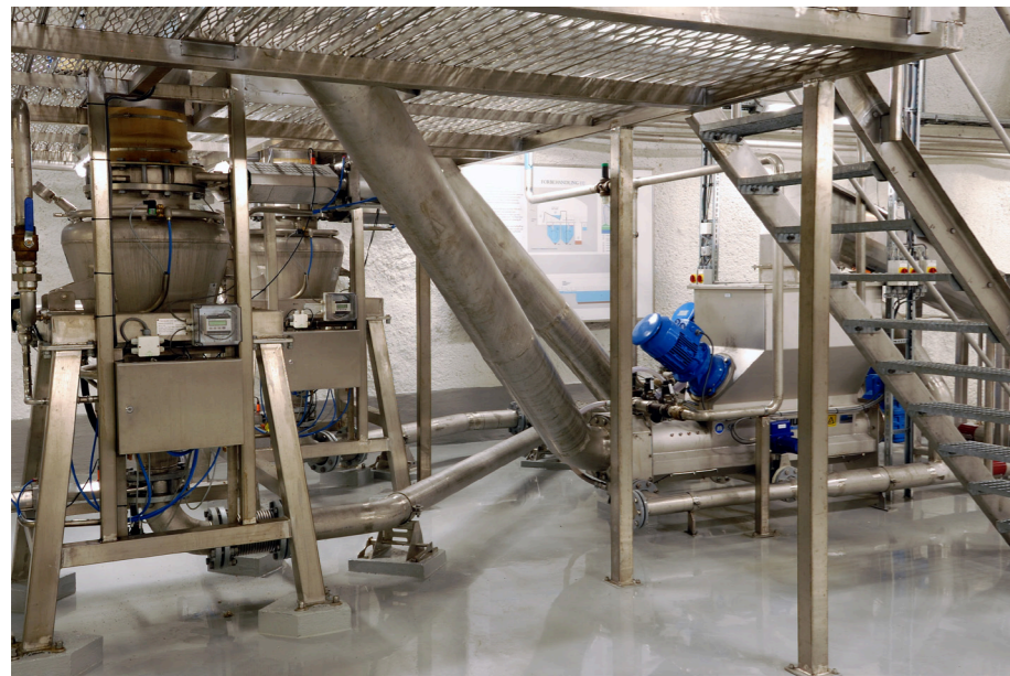
Ristgodsvaske med tilhørende ristgodskanon for transport til containere
