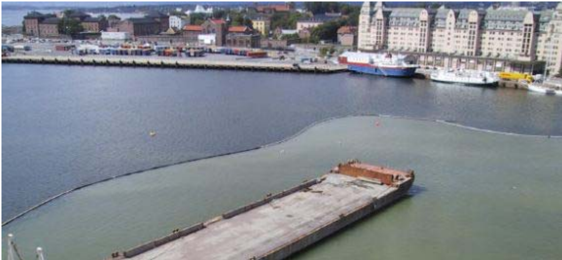
Figur 16 Foto fra bygging av Operaen i Oslo, som illustrerer virkningen av ei partikkelsperre. Foto tatt av Johs. J. Syltern AS ( www.syltern.no ).
