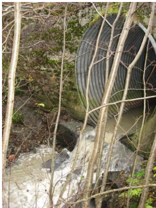
Kulvert før tiltak
