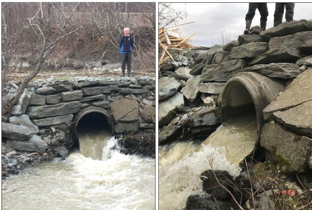
Figur 7.30. Problematiske vandringmuligheter for sjørret gjennom kulvert i landbruksvei i nedre del.
