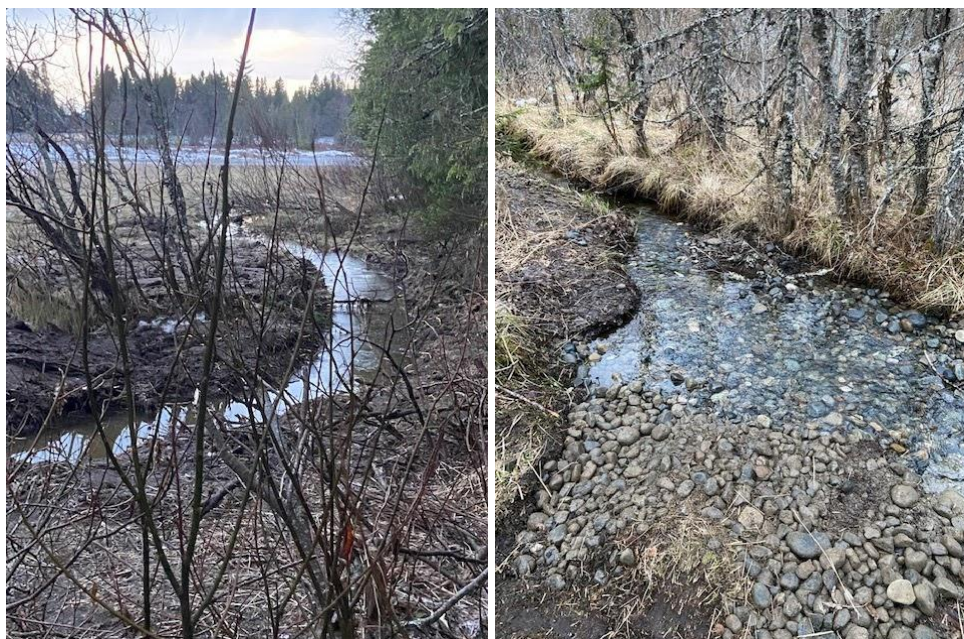
Figur 7.46. Tilløpsbekken til Lianvatnet er gravd ut i nedre del (venstre) og gytegrus er lagt ut (høyre).
