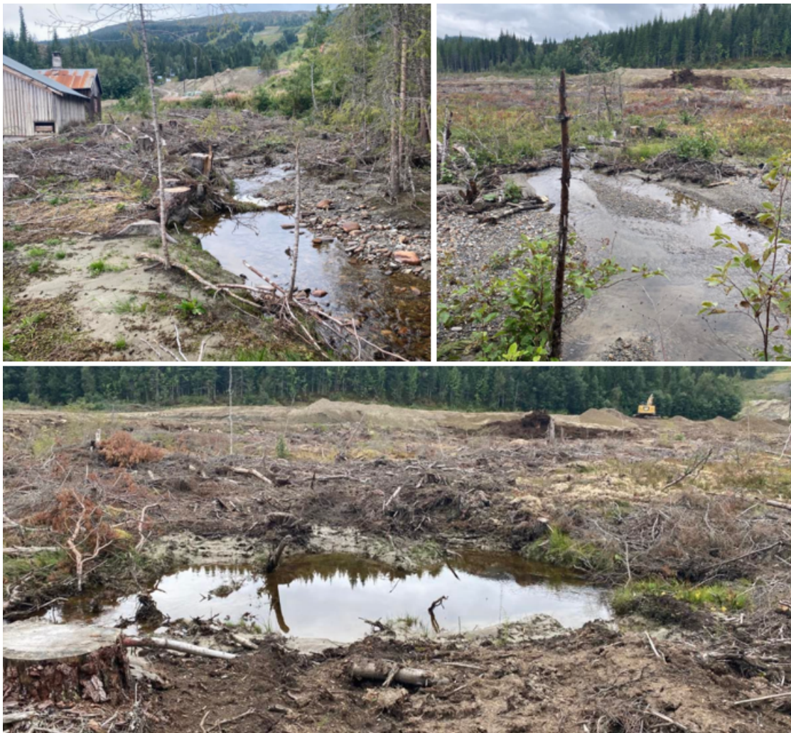
Figur 7.21. Merkesbekken etter store inngrep i og langs bekkeløpet i løpet av 2021.
