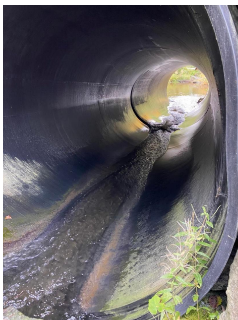
Figur 7.34. Vandringshindrende veikulvert under Mebygdveien må utbedres. Foto: NINA.
