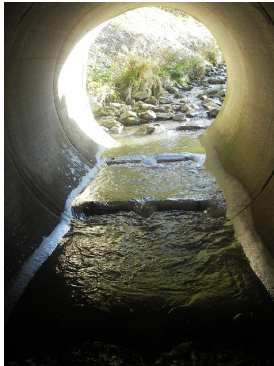
Figur 6.53. Biotopforbedring i Heimdalsbekken 2006. Etablering av terskler inne i kulvert (øverst) og tilrettelegging av gyte- og oppvekstområder nedenfor kulvert (nederst).
