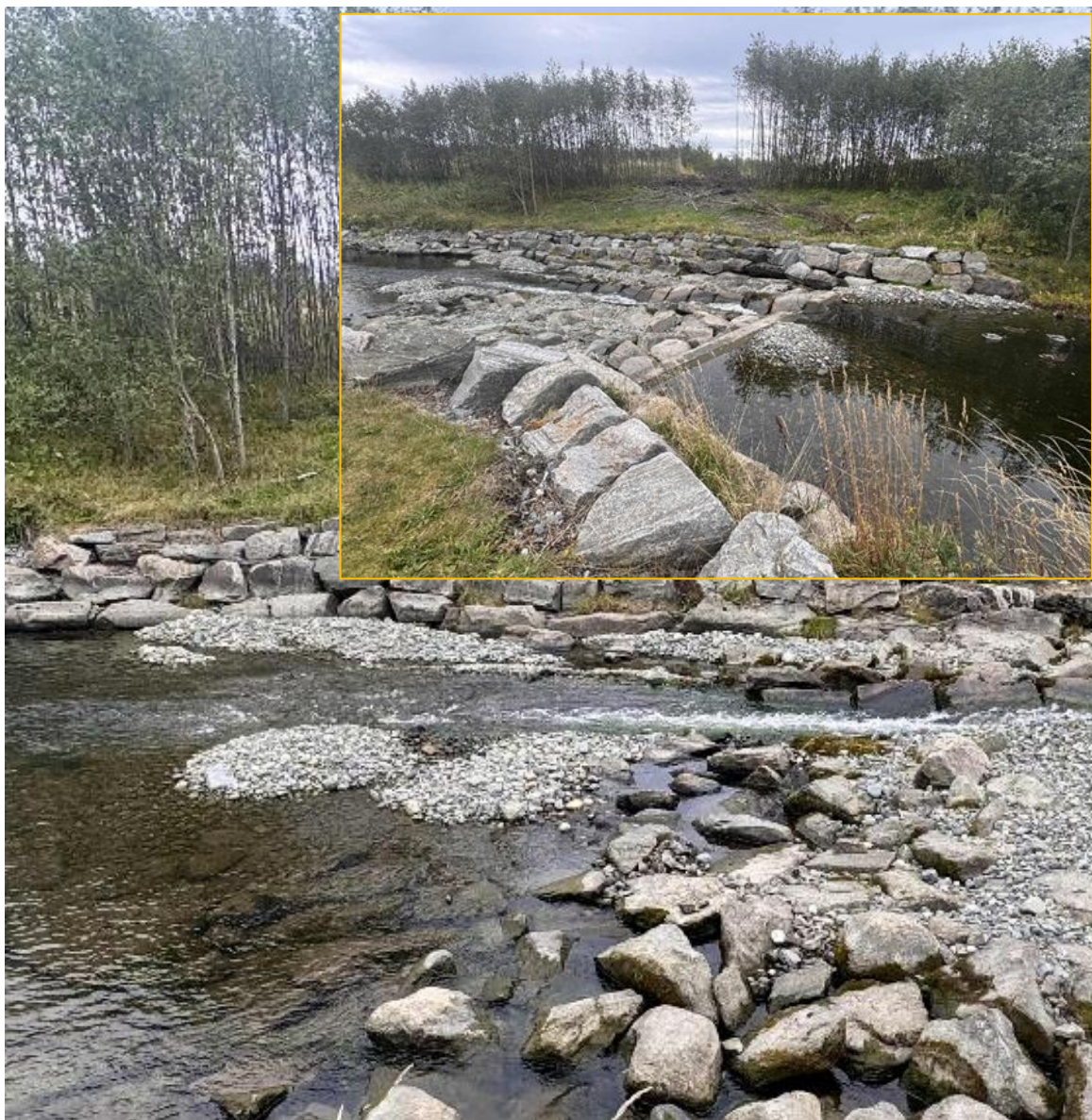
Figur 67. Gytesubstrat ble i 2025 tilført i deponier for naturlig nedstrøms transport og tilrettelegging på flom i Vikelva. Substrat ble tilført både nedstrøms (stort bilde) og oppstrøms (innfelt) øvre terskel.
