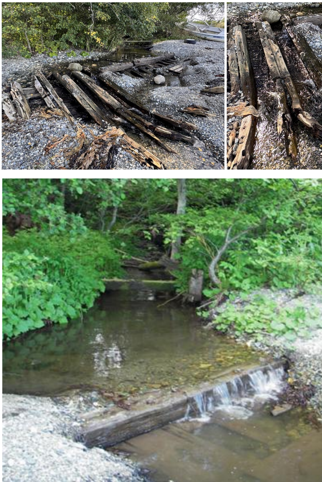
Figur 81. Øverst: Mulig vandringsvei for større sjørrret gjennom «renner» i trekonstruksjonen på spesielle vannføringer i 2025. Nederst: Status på samme parti og inngrep i 2006. Noe kulp nedstrøms trekonstruksjon gjorde det mulig å forsere problempunktet på høyere vannføringer. Foto hentet fra Bergan mfl. (2008).
