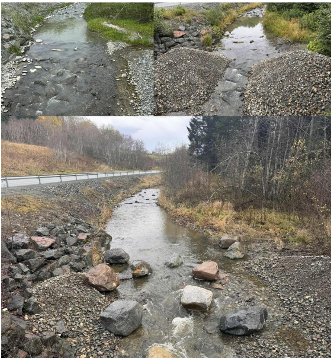
Figur 39. Tiltaksstrekning i Amundbekken ved samløp Svartdalsbekken. Foto fra mai 2025 øverst til venstre, august 2025 øverst til høyre. Status i oktober 2025 nederst, etter ulike flomperioder har fordelt gytesubstrat fra deponiene, og storstein er tilført.
