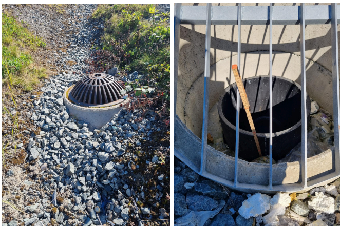
Figur 7.1: Eksempler på inntakskummer for overvann som ikke fungerer effektivt.
