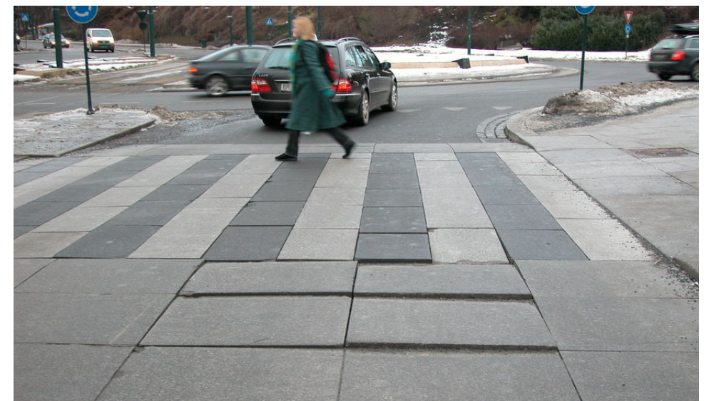
Fig. 4-26: Eksempel på konsekvenser ved dårlig utførelse. Dette gir redusert fremkommelighet og ser heller ikke pent ut. Foto: Torbjørn Vinje, NKF
