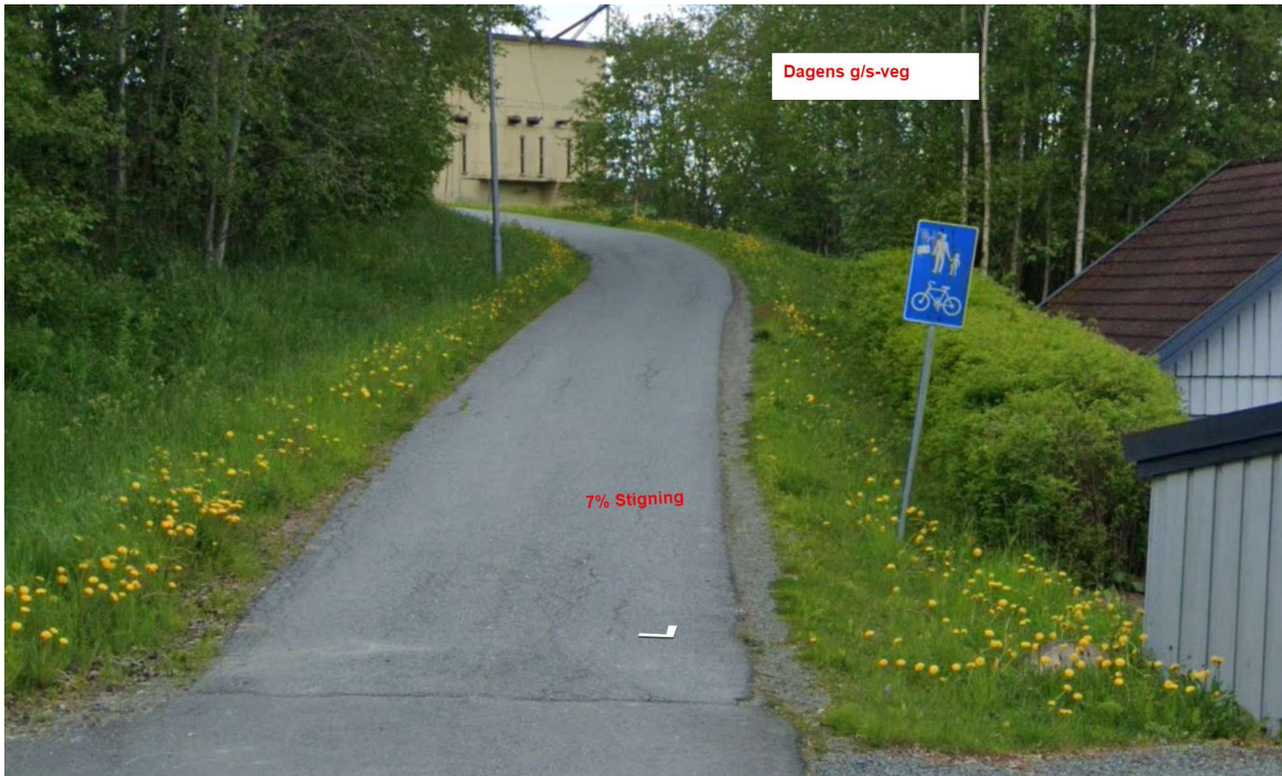
Figur 6-4. Dagens vegløsninger i Sivert Dahlens veg ivaretar ikke krav om universell utforming for gang- og sykkelvegen. Som det kommer frem av bildet tatt ved øvre del av den kommunale veggen, er det et parti med stigning 7 %. Vegdekket er dårlig, og asfalten er flere steder sprukket opp.
