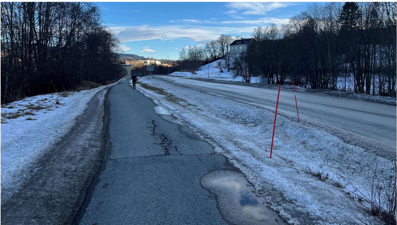
Figur 2-1. Rv. 706 Osloveien og Sivert Dahlens veg er veganleggene som omfattes av konsekvensutredningen. Bildet viser situasjon ved avkjøring til Dorthealyst i februar 2024.
