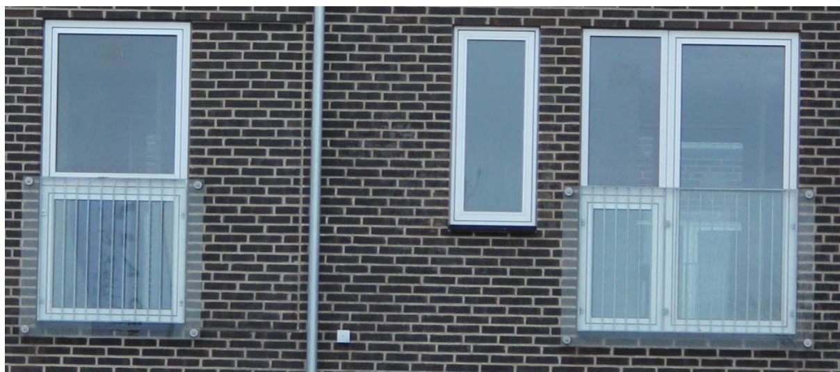
Figur 17 - Oplukkelige vinduer, placeret bag tæt glasskærm m. plads til luftindtag i siderne.
