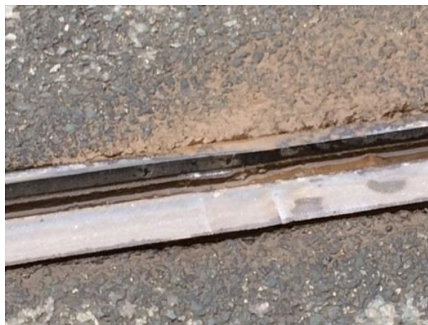
Bildet viser et trikkespor, noe deformert.
