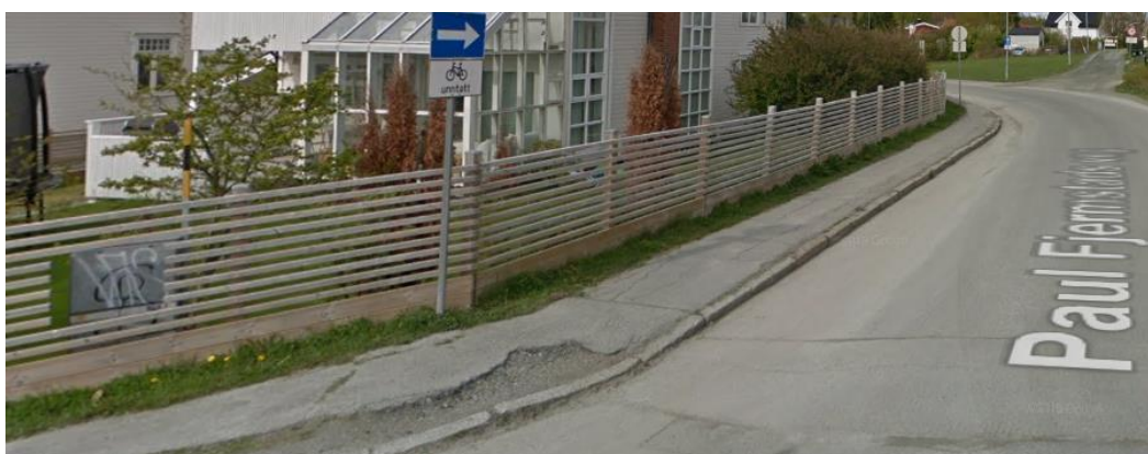
Figur 24: Eksempel på dårlig asfaltdekke på fortau i Paul Fjermstads gate
