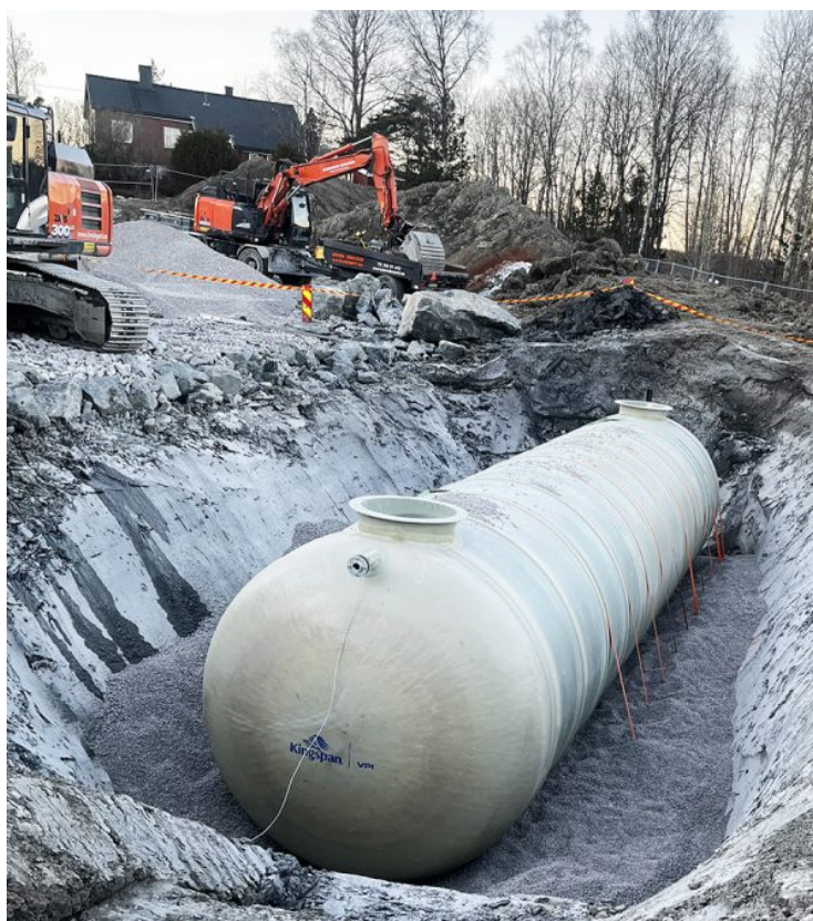
Eksempel på hvordan nedgravde slokkevannstanker kan se ut.
