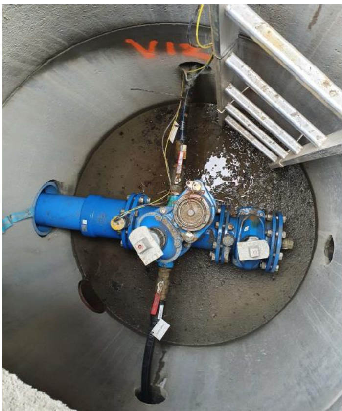
BILDE 5: EKSIST. VANNKUM 382649
