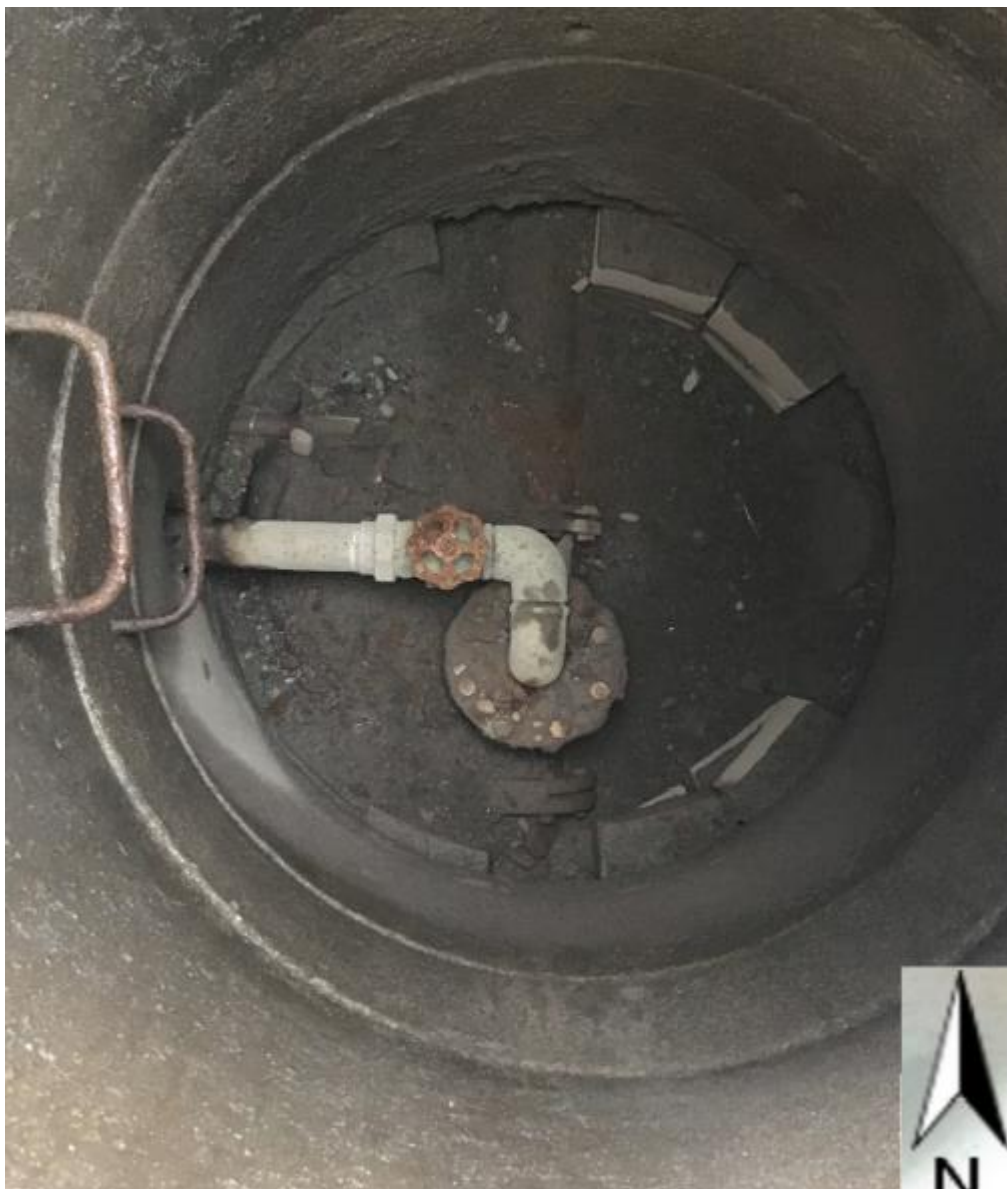
BILDE 4: EKSISTERENDE TILKNYTNING AV VL75 TIL VL150 I NORDRE GATE - VANNKUM 8323
