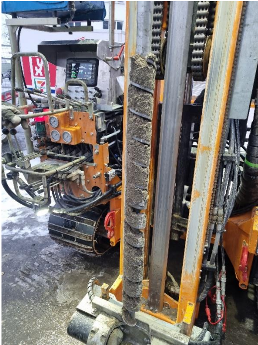
Figur 5-1: Borhull M9 (1-2 meter under terreng). 2 meter mektig øvre lag av fyllmasser bestående av brun sand med grus og stein.
