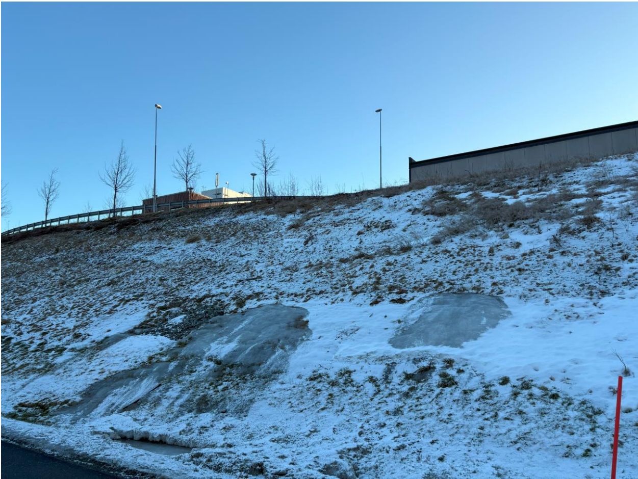
Figur 7: Observasjoner fra befaring utført 11.02.2025 som viser tydelig vanntransport ut av skråningen
