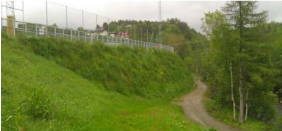
Figur 33 Eksempel på grønn mur fra Aure kommune bygd ifm nytt idrettsanlegg i 2013. Muren er ca 10 m høy og er godt tilpasset et friområde langs elva nedenfor.
