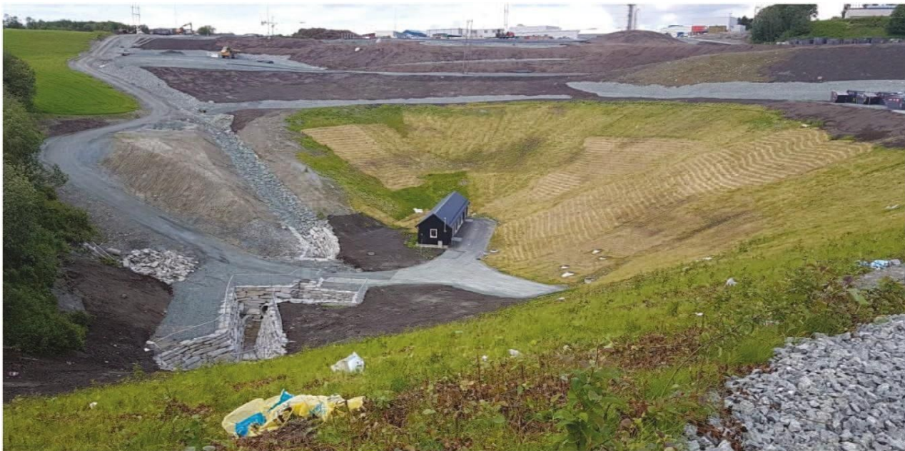
Figur 10: Heggstadmoen avfallsdeponi er nå dekket til med tette masser. Sigevann samles opp og pumpes videre til rensing. Sigevannsstasjonen sees sentralt i bildet. Rent overvann går til Heggstadbekken. Deponigassen ledes til oksidasjonsvinduer. Området ble offisielt avsluttet og gikk over til etterdrift 1. august 2018. Foto: Trondheim kommune.
