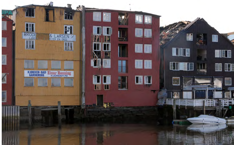
Fjordgaten 76-80 etter brannen 17.mai 2007. Skadene var så omfattende at bryggene ikke var til å redde. Viser med stor tydelighet hvilke konsekvenser en bryggebrann kan få.
