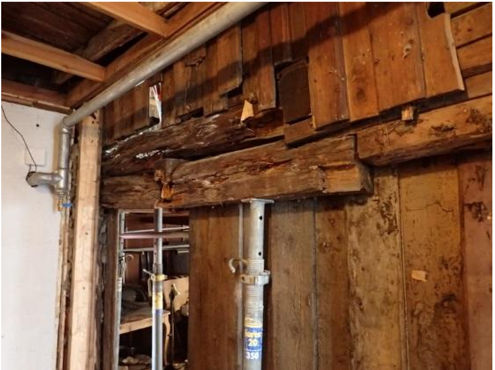
Vår Frues Gate 4. Råteskadet vegg
