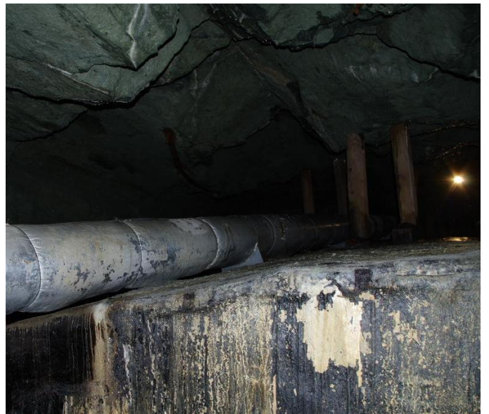
Fig. 8-4: Steinhaugen. Ventilasjonsrør over bunker.
