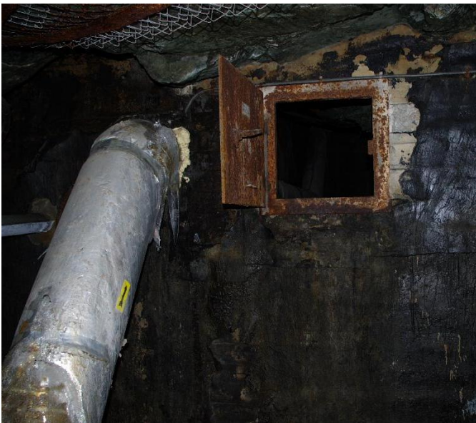
Fig. 8-3: Steinhaugen. Ventilasjonsrør og luke.
