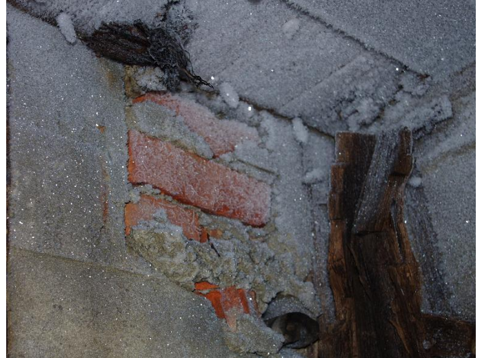
Fig. 16-2: Frost i tak og vegger inne i rom i bunker nr. 16. Lite egnet for flaggermus.
