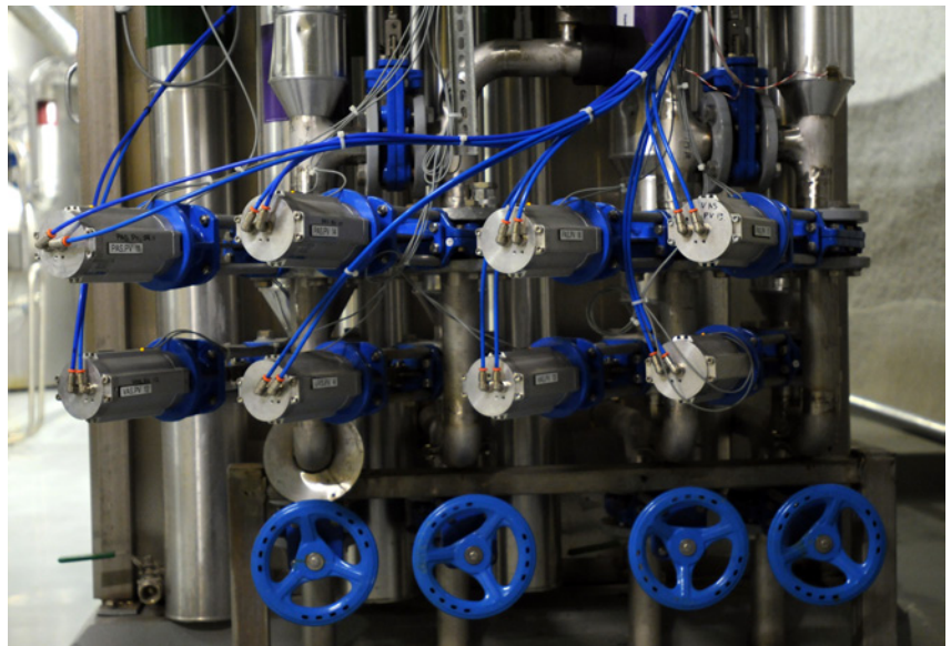
Trondheim kommunes vannrenseanlegg
